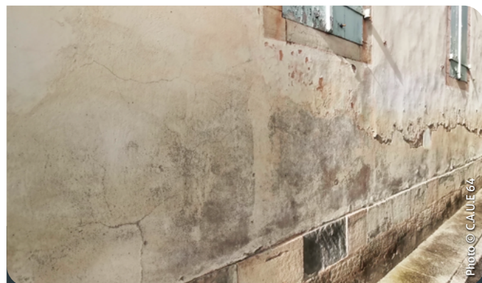
Pied de mur humide à cause des remontées capillaires : l'enduit ciment ne permet pas à l'humidité de s'échapper naturellement
